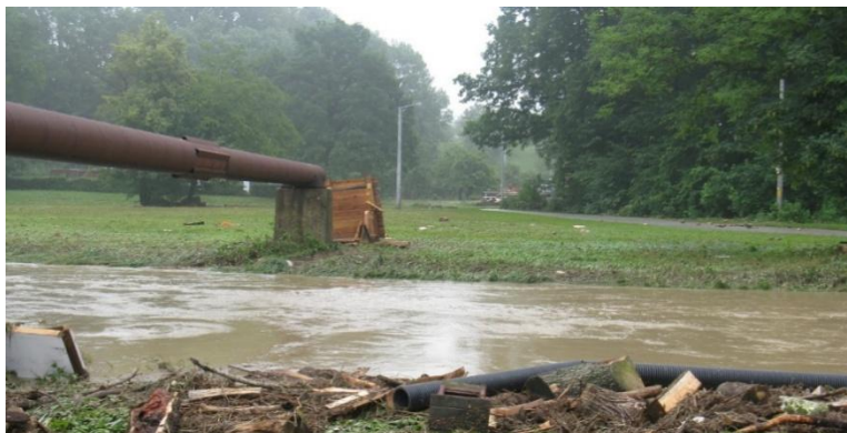
vodovodní porubí u mostu přes Odru, povodeň červen 2009
